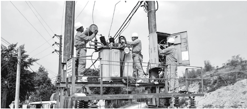
Cán bộ, công nhân kỹ thuật kiểm tra công tác an toàn, đảm bảo cung cấp điện ổn định và tiết kiệm
